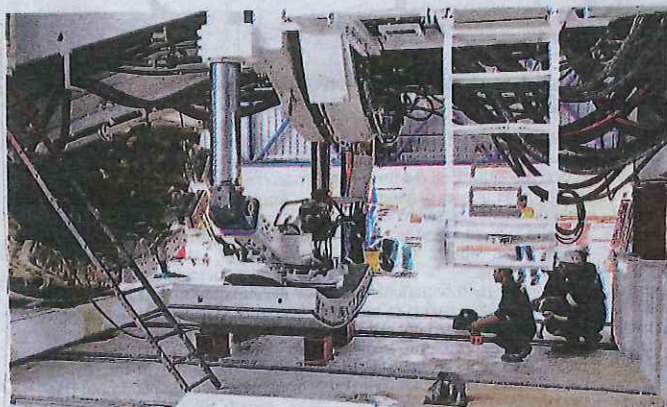
Kru TTA memeriksa Mesin Pengorek Terowong (TBM) di kilang baik pulih di Pusing, Ipoh.
